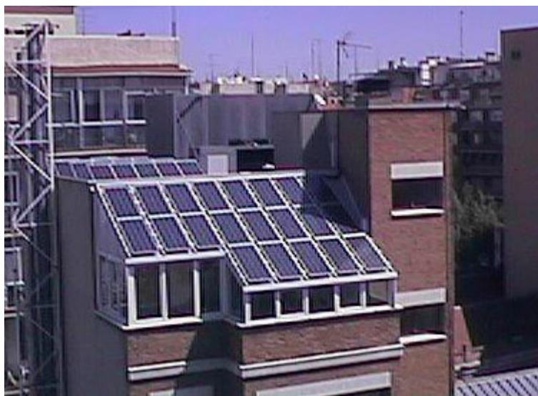
Fotografía 1. Vista de la instalación fotovoltaica del IIT
